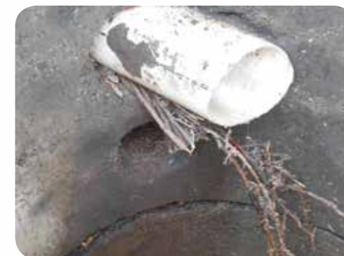
Foto 16: Raízes saindo ao redor do cano de esgoto
