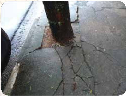
Foto 17: Calçada danificada pelo tamanho inadequado do canteiro
