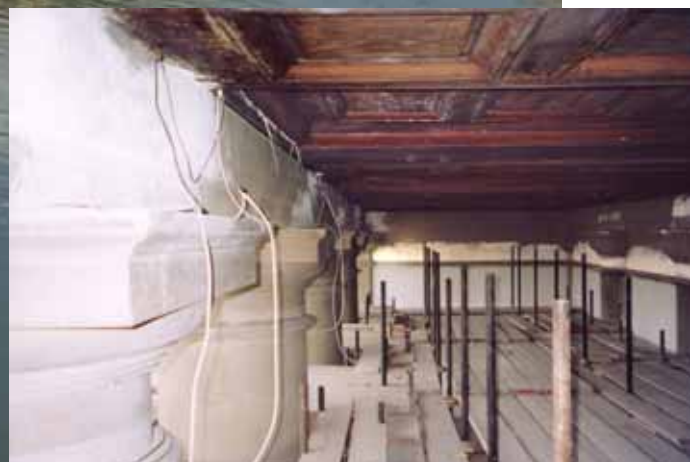
Un particolare del colonnato sul lungarno durante i recenti lavori di restauro delle facciate. A close-up of the colonnade on the Arno River embankment while the façade was being restored.
