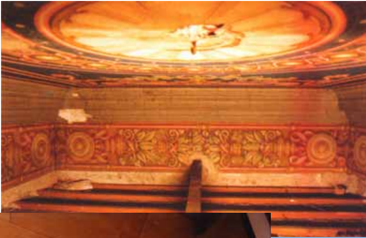
Le decorazioni di Galileo Chini "nascoste" al di sopra del controsoffitto in legno.
