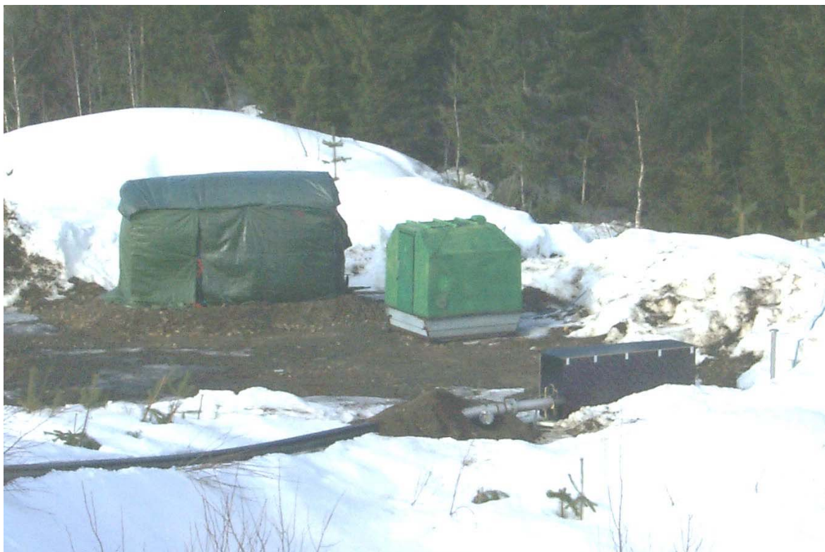
Kuva 12. Yleiskuva kaivon K5 ympäristöstä. Kuvassa näkyvät aggregaatti- ja sähkölaitesuojat, kaivoventtiili- ja mittalaitesuoja sekä havaintoputki PP36 (oik.) (Joensuun Vesi).
