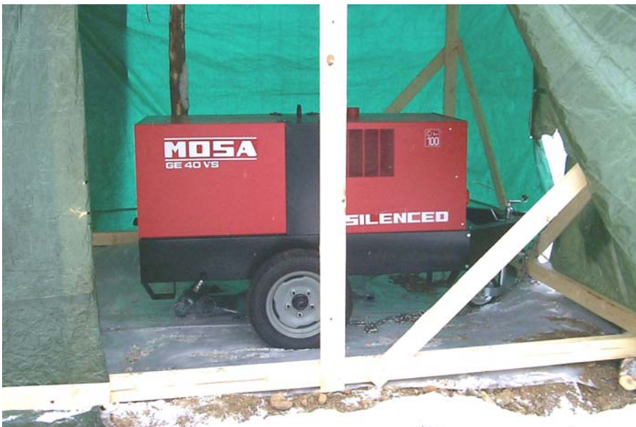
Kuva 14. Kaivon K3 yhteyteen sijoitettu dieselkäyttöinen, 43 kW:n MOSA GE 40 VS aggregaatti (Joensuun Vesi).
