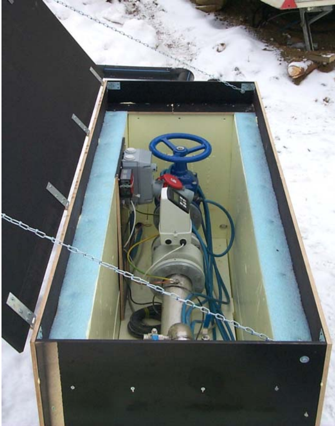
Kuva 13. Osittain kaivon päällä oleva mittareiden ja venttiilien suojalaatikko. Kuvassa etualalla kaivosta tuleva putki, virtaamamittari ja säätöventtiili, jolla säädelään kaivon tuottoa (Joensuun Vesi).
