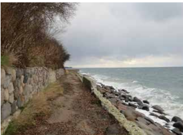
Dele af kyststien som er meget ødelagt og ikke er renoveret
