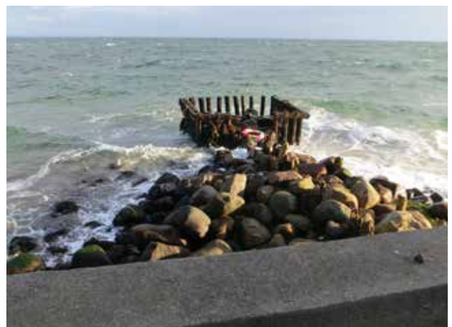
Resterne af tidligere højde og badebro, som ønskes renoveret
