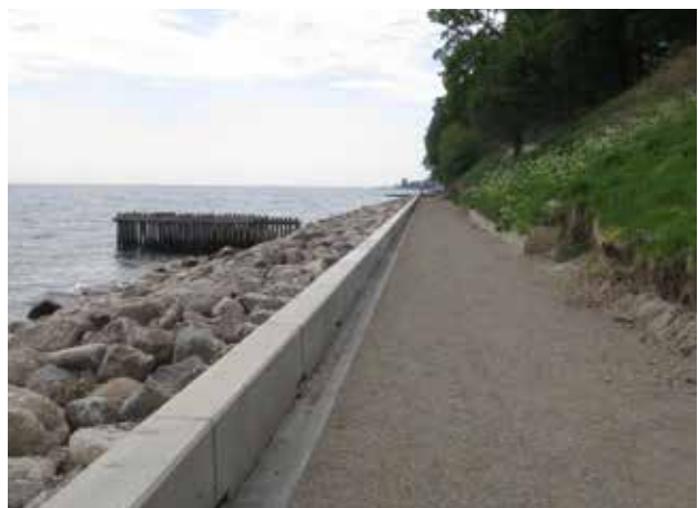
Delstrækning som er renoveret med ny lav betonmur og kystsikring indviet i 2016. Højde og skrånning, som er del af parken mangler renovering.
