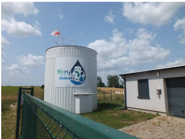
9. Widok na stację podnoszenia ciśnienia zlokalizowaną za południową granicą obszaru objętego planem
