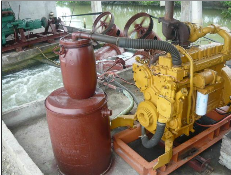
Foto 11 Vista de uno de los motores que conforman la Estación de Bombeo
