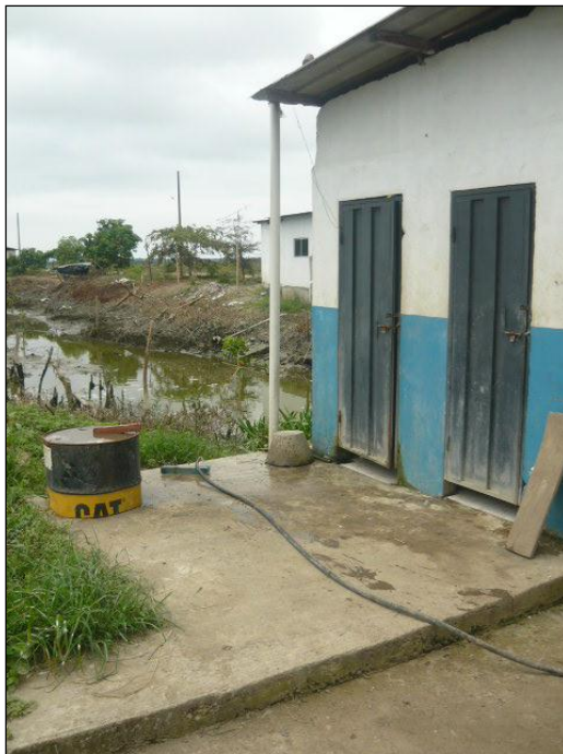
Foto 9 Vista en primer plano de la loseta del pozo séptico. Obsérvese sobre este la batería Sanitaria y el respectivo tubo de ventilación.
