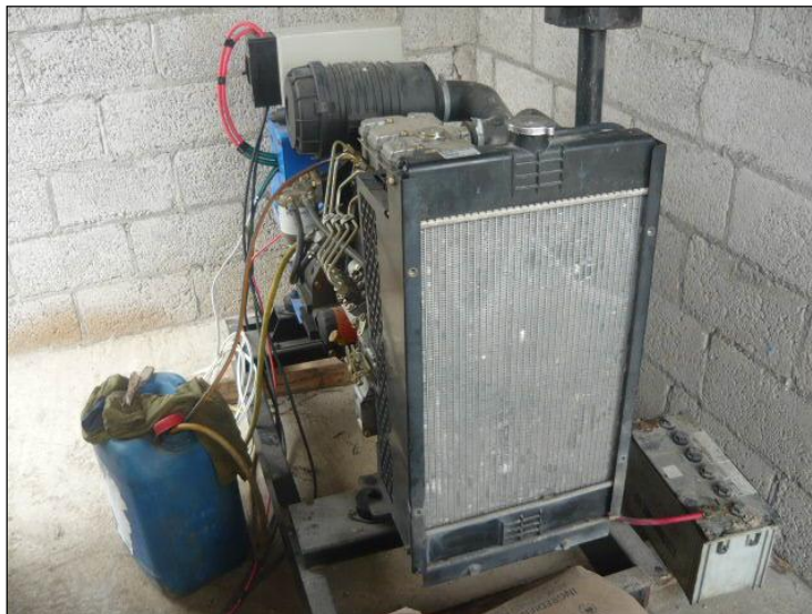
Foto 7 Vista del generador auxiliar de energía eléctrica. El área o cuarto donde está implantado e encuentra en construcción/mejoramiento
