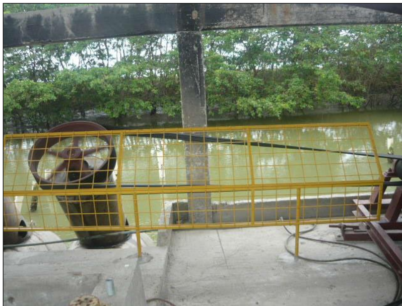
Foto 12 Vista de una turbina de 36" que conforman la Estación de Bombeo. Obsérvese la malla metálica de protección para el personal que labora en esta área
