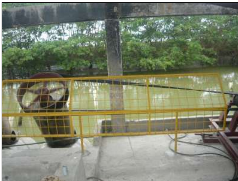
Foto 12 Vista de una turbina de 36" que conforman la Estación de Bombeo. Obsérvese la malla metálica de protección para el personal que labora en esta área
