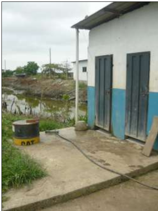
Foto 9 Vista en primer plano de la loseta del pozo séptico. Obsérvese sobre este la batería Sanitaria y el respectivo tubo de ventilación.
