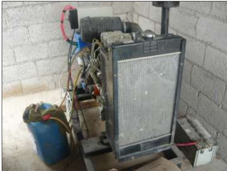
Foto 7 Vista del generador auxiliar de energía eléctrica. El área o cuarto donde está implantado e encuentra en construcción/mejoramiento
