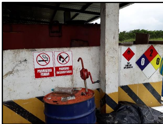
Tanque de combustible
