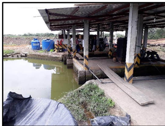
Estación de bombeo
