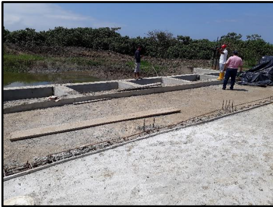
Estación de bombeo
