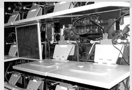
Positionierung von TFT-Bildschirmen in Videoüberwachungsanlagen
