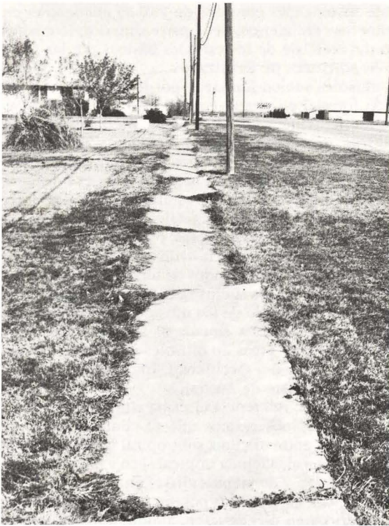
FIGURA 23.2. Losas de la acera basculadas debido al movimiento de suelos de tipo vertisoles (arcillas negras de Houston), Travis County, Texas. (Servicio de Conservación del Suelo, Departamento de Agricultura de los EE.UU.)
