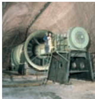
links oben Der beeindruckende Hauptgrubenlüfter des Kali- und Steinsalzwerkes Niedersachsen-Riedel bewegte pro Minute 27.000 Kubikmeter Frischluft (1982).
