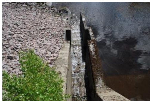
Gamla fiskvägen vid regleringsdammen, inte
