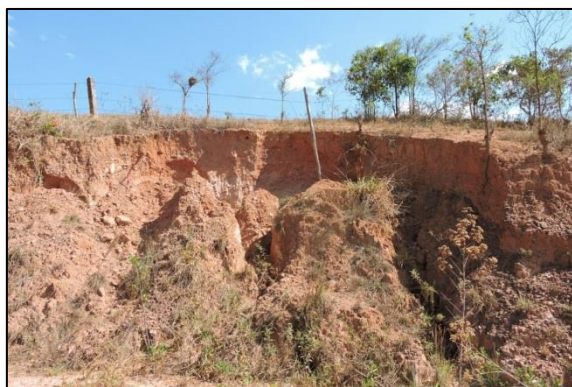
Figura 71 - Erosão em beira de estrada Bacia do Córrego Candidópolis 03
