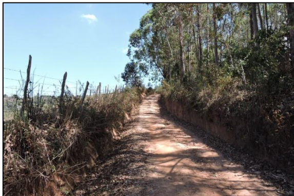
Figura 99 - Condições da estrada
