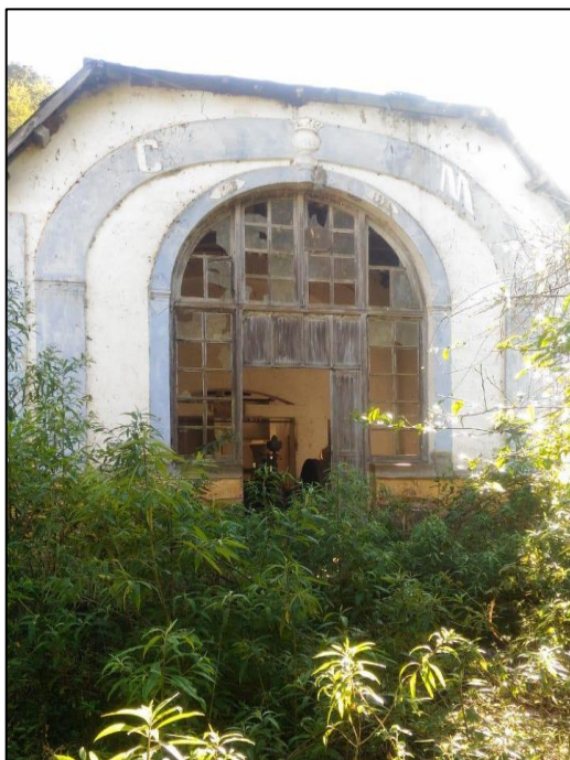
Figura 226 - Casa de máquinas da Usina Hidrelétrica Ribeirão São José
