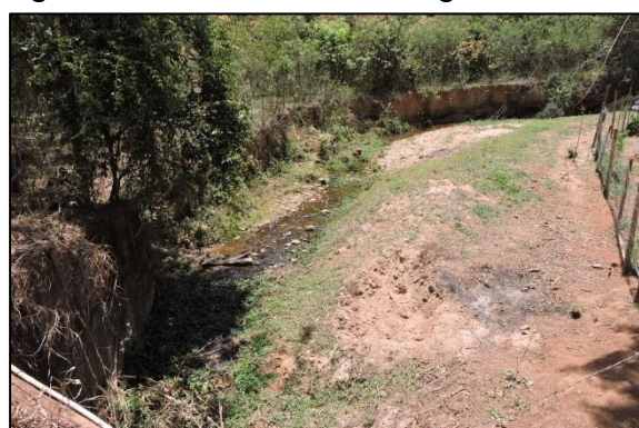
Figura 108 - Curva do córrego assoreada
