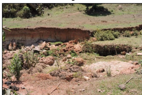
Figura 106 - Erosão na margem de curso d'água
