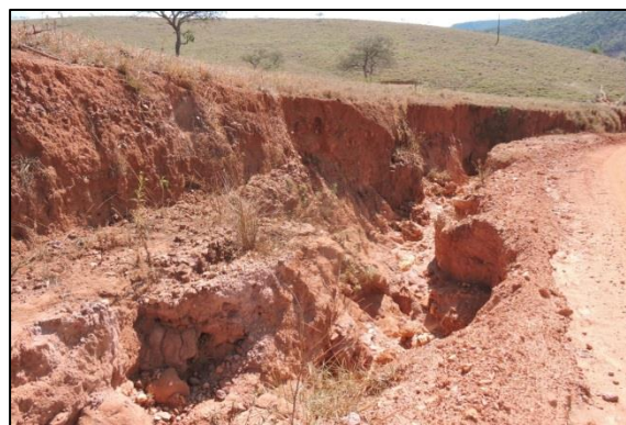
Figura 72 - Erosão em beira de estrada Bacia do Córrego Candidópolis 04
