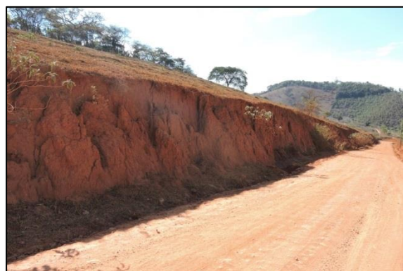
Figura 76 - Erosão em talude para corte de estrada -
