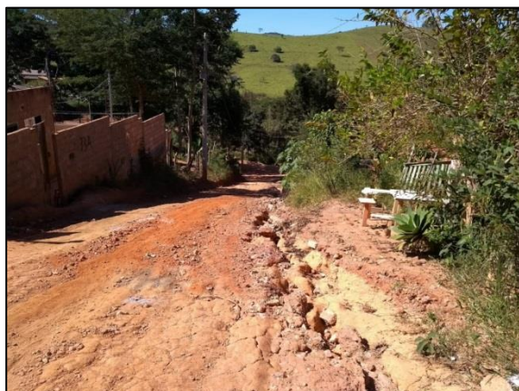
Figura 79 - Ravina em estrada
