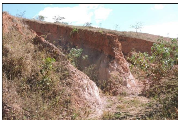
Figura 69 - Erosão em beira de estrada Bacia do Córrego Candidópolis 01
