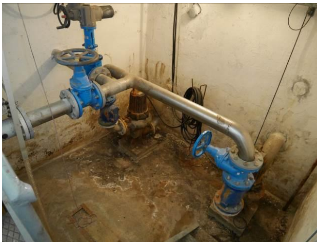
Recirkulációs szivattyú I. gépészet
