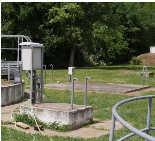
Uzsadék átemelő akna, Recirkulációs átemelő akna I.
