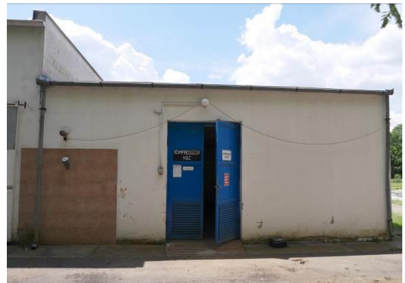
Vegyszeradagoló és kompresszor gépház
