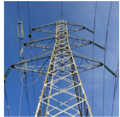
Das optische Luftkabel (OPGW) befindet sich an der Mastspitze
