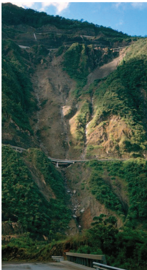
A. deslizamientos de ladera Km 23-16
