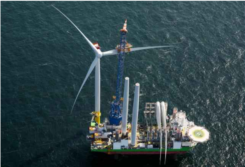
Figur 4-21. Vid installation av vindkraftverk används jack-up-fartyg för att placera komponenterna av vindkraftverket på platsen.
