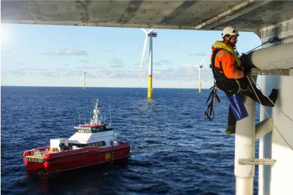
Figur 4-22. Inspektions- och underhållstekniker på en havsbaserad plattform, samt transportfartyg.
