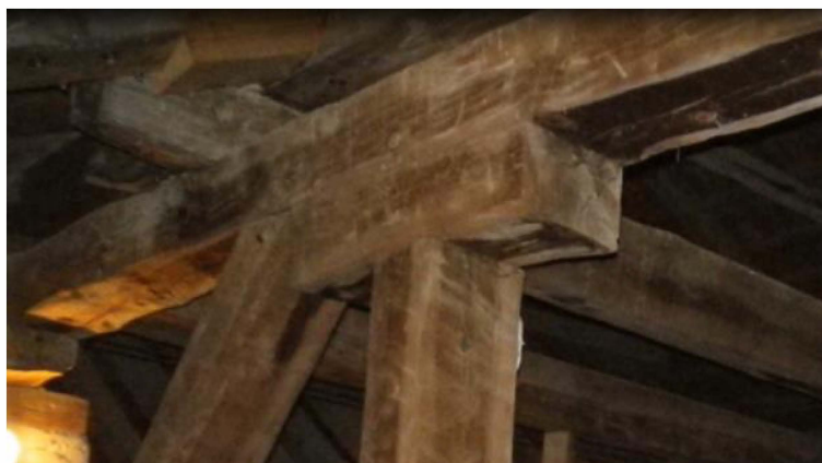
DETALLE DE LAS TIRANTAS Y DE LAS CARRERAS DE CERCHAS, BUENA PARTE DE ELLAS RESTAURADAS
