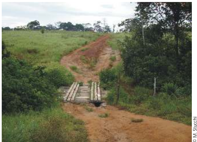
Figura 8. Erosión del suelo debido a las lluvias y al paso de vehículos, caserío Los Ángeles, camino al sector Palma.
