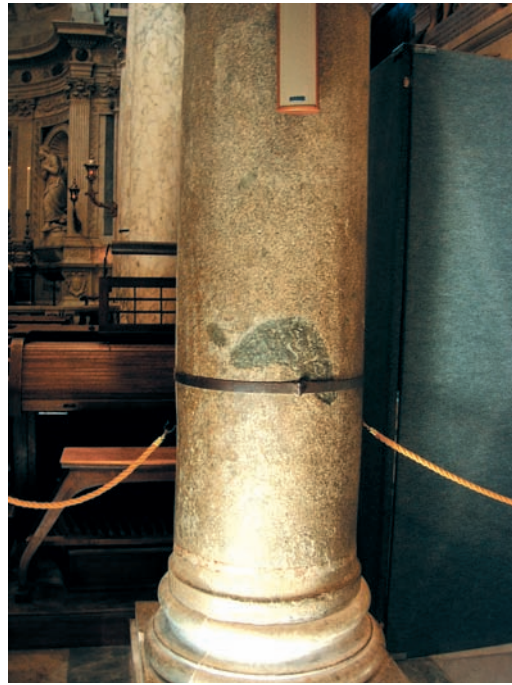
Figura 5b: interno del Duomo di Pisa, transetto sinistro, grossa plaga di pinite in una colonna.
