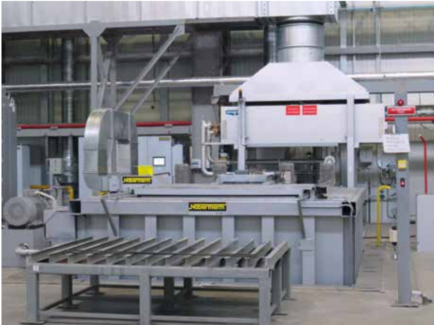
Ölabschreckbad OAB 67000 mit Wärmetauscher mit einem Inhalt von 67.000 Litern Öl
