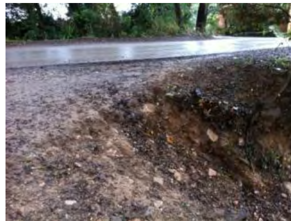
Coronamiento del talud erosionado
