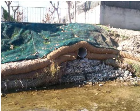
Detalle de la salida del colector
