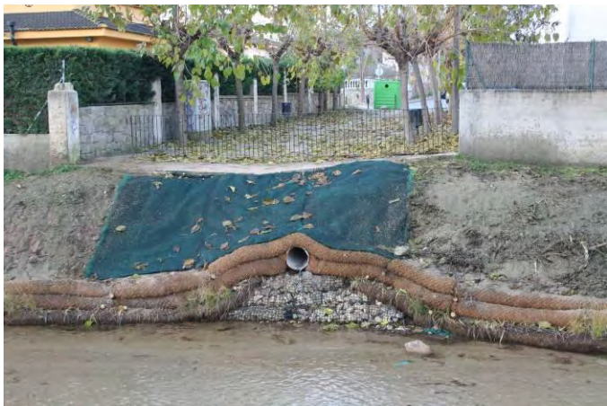
La zona una vez terminada, protegida e integrada con la Rollada viva riparial
