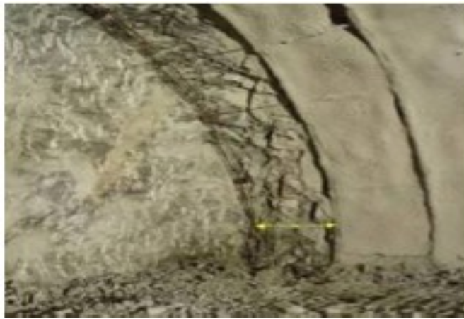
Σχήμα 1.15: Πτωχή ποιότητα βραχώμαζας – μικρό βήμα εκσκαφής.
