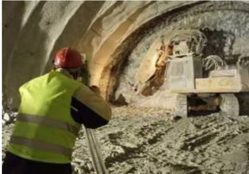
Σχήμα 2.13: Έλεγχος γεωμετρίας πλαισίου. Φαίνεται δικτυωτό πλαίσιο Lattice/Girder.
