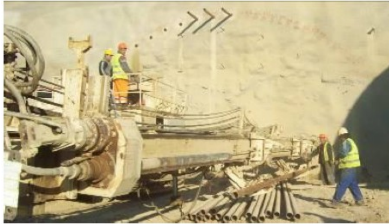
Σχήμα 1.19: Δοκοί προπορείας στο στόμιο της σήραγγας T1, Τέμπη.
