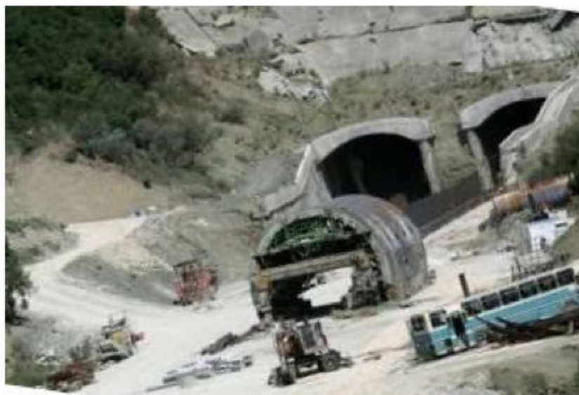
Σχήμα 1.13: Μέθοδος Cover & Cut. Διακρίνονται τα πλευρικά τοιχεία, η άνω πλάκα καθώς και το επίχωμα.
