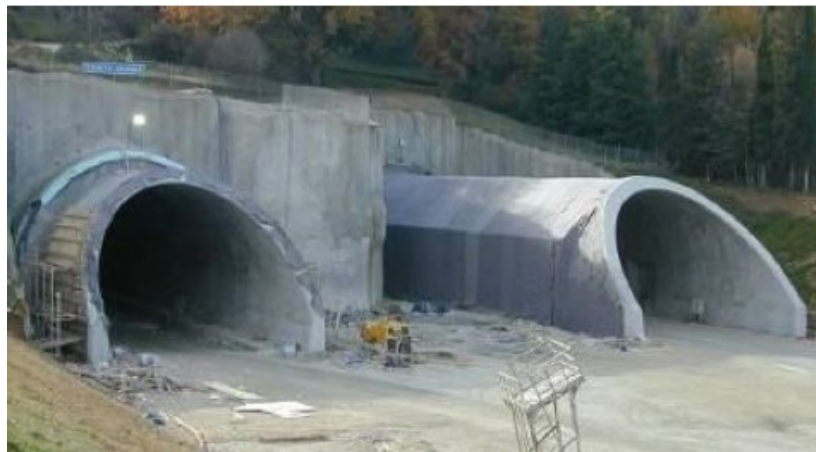
Σχήμα 1.26: Άποψη της τελικής επένδυσης στο τμήμα Cut & Cover. Εγνατία Οδός, Σήραγγα Δωδώνης.
