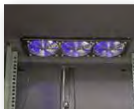
3 x Super-Silent Lüfter im Dachbereich
