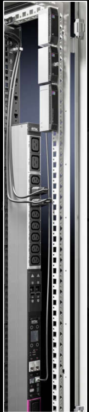
Anwendungsspezifische Sensoren können direkt über die CAN-Bus-Schnittstelle der PDU in das zentrale Monitoring eingebunden werden.
