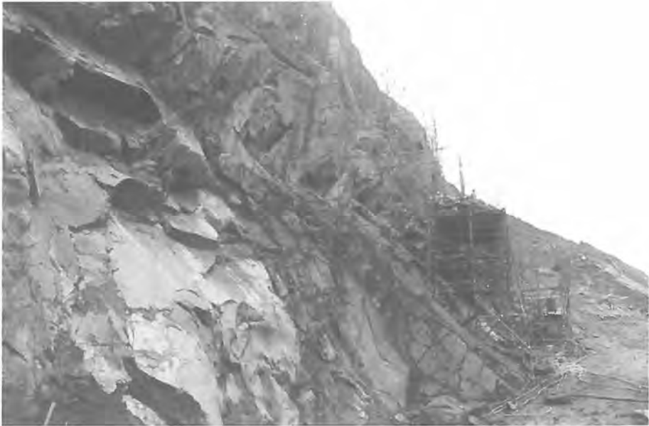
Fig. 5. Eksempel på stabilitetsproblem pga. markert underkuttende dalsidesprekk.
