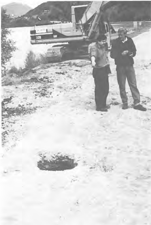
Figur 6. Et hull oppsto plutselig ved utbedring av E6 ved Mageli
