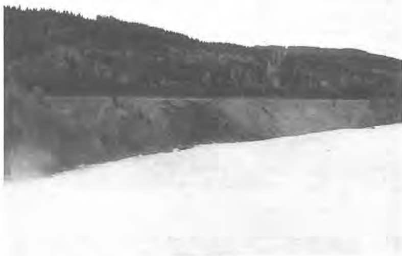
Figur 4. Erosjonsskade på E6 ved Hunderfossen
