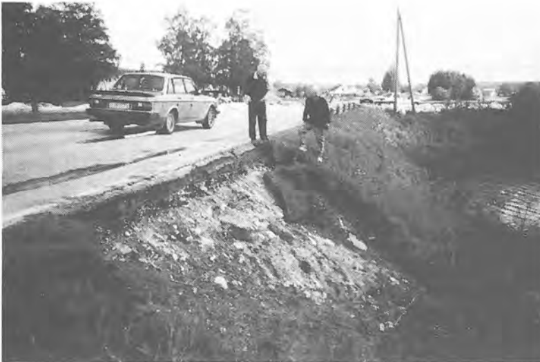
Figur 3. Erosjon i skråning (overflateglidning) på grunn av høy vannstand og vannstrømning. Fra fv. 206 ved Sandstad bru i Hedmark
