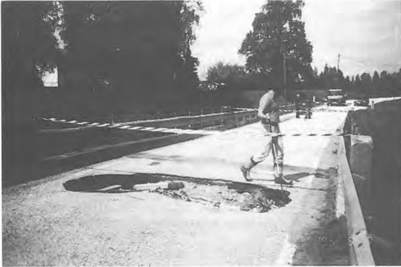
Figur 2. Typisk hull i vegbanen ved landkar som følge av utvasking. Fra rv. 210 ved Nesa bru i Hedmark.
