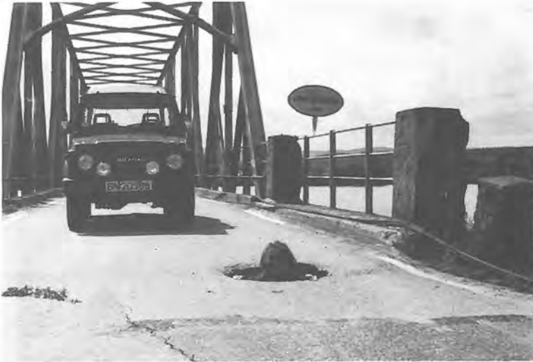
Figur 7. Hull i vegbanen på tilløpsfylling ved Arneberg bru, fv 434 i Hedmark.
