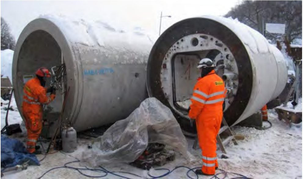
Figur 28 Trykkluse og rør ved S9. Diameter 2,4 m.
