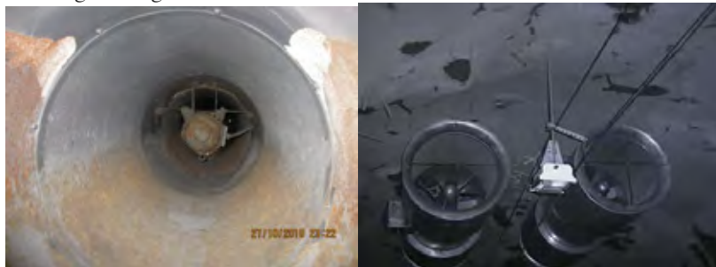
Figur 14 og 15. Gamle rustne vifter uten blad og nye vifter med støydemping.
