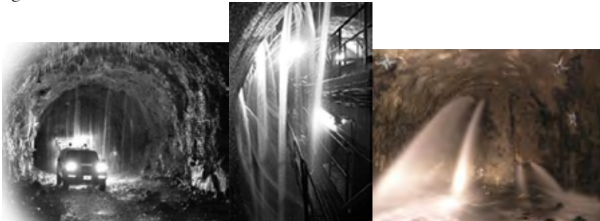
Figur 11, 12 og 13. Store vannlekkasjer
