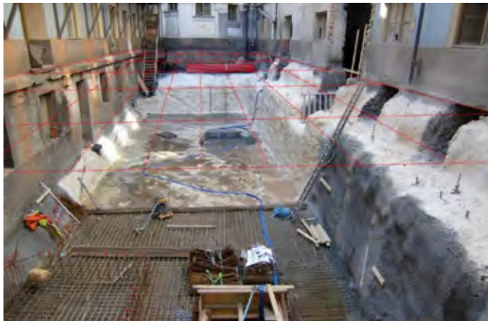
Figur 11: Ferdig sikret byggegrop. Opprinnelig nivå av gårdsrom, som skal reetableres, er vist med rødt rutenett
