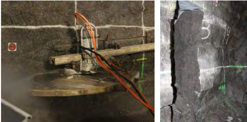
Figur 12-Sågning av snitt i tunnelväggen i TASN för att studera spränginducerade sprickor under hösten 2014.
