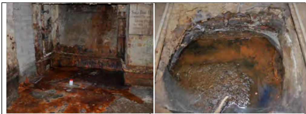
Figur 1: Figur til venstre viser en drenert løsning er det skjer et vannsig inn gjennom teglsteinsveggen ca en halv meter opp på veggen. Figur til høyre viser sammenblanding av grunnvann og avløpsvann fra bygning. Sannsynligvis defekte rør eller feilkoblinger fra tidligere rehabilitering.
