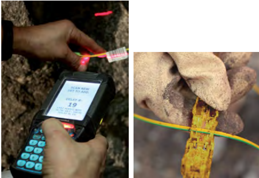
Figur 4 Scanning av strekkode (t.v.). Kobling av busskabel i blokk før den knipses sammen (t.h).
