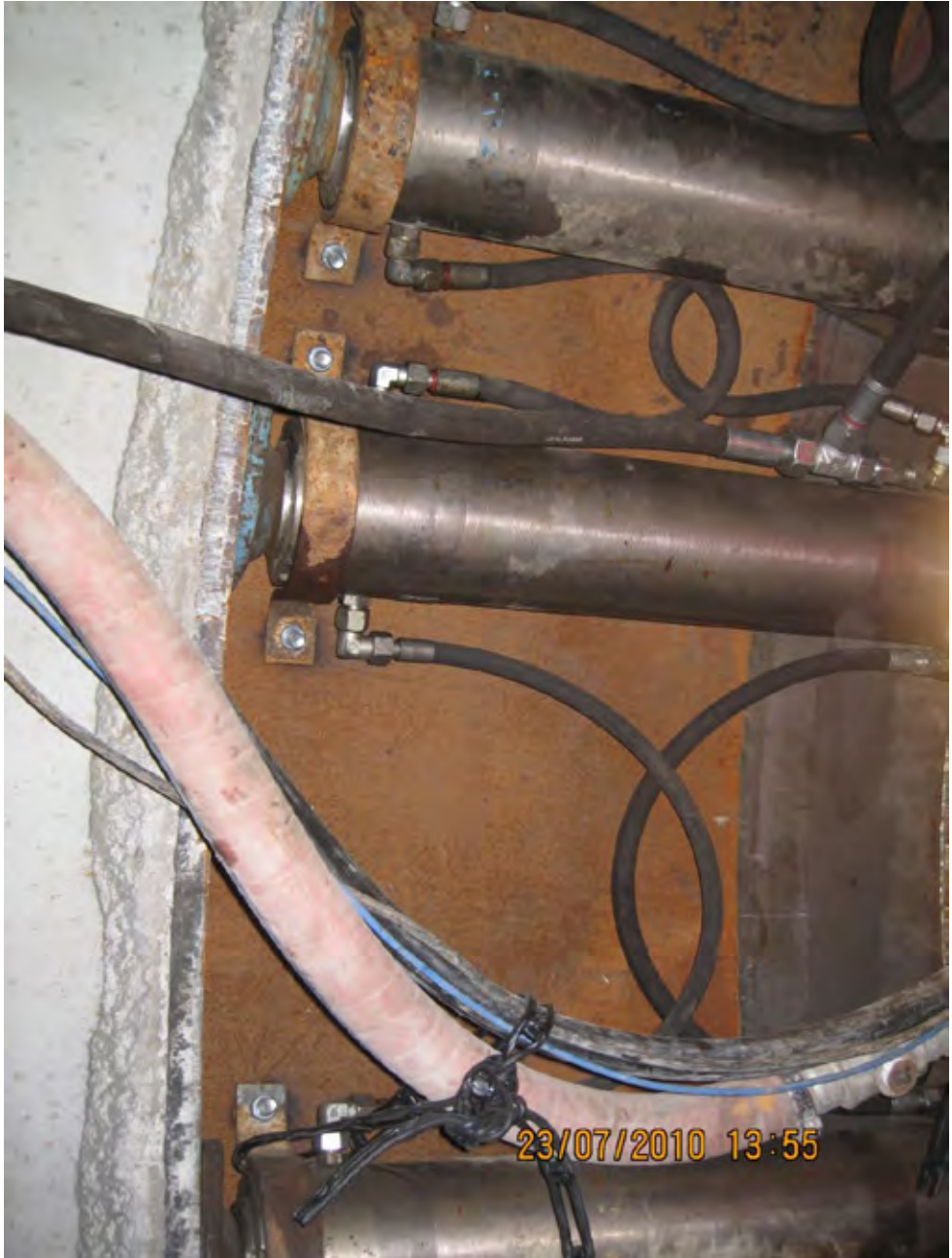
Figur 18 Mellomtrykkstasjon montert i en rørskjøt med stålplate på utsiden. Det er en rekke sylindreljekker med noen desimeter slaglengde.
