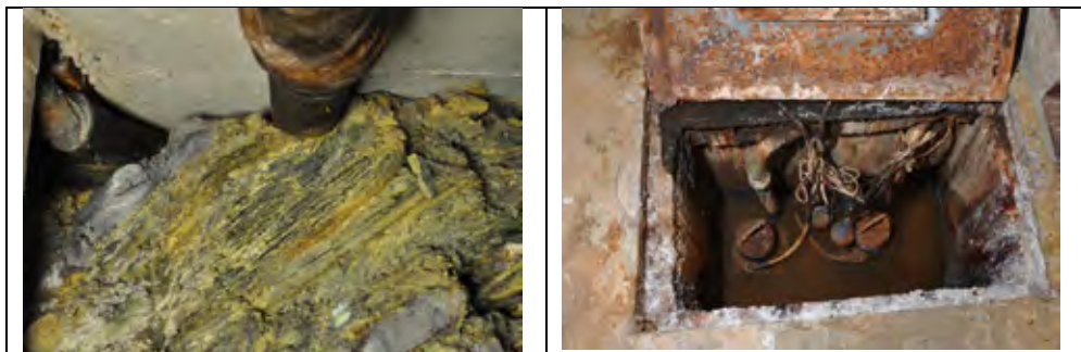
Figur 2: Bildet til venstre, forvitring med volumutvidelse under frittstående gulv. Legg her merke til forvittringsomfang og at det er etablert drenert løsning. Drenert løsning innebærer både potensielle skader på bygninger og miljøbelastning ved at sigevann kan være kraftig anrikt på tungmetaller, uran og aluminium. Bildet til høyre viser en pumpesump. Denne drenerer grunnvann og pumper forurenset vann med tungmetaller og uran ut på ledningsnettet. Se også figur 5.
