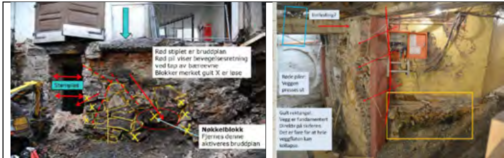
Figur 8: Bildet til venstre viser mur av stablestein (tørrmur) med dårlig stabilitet. Her ble det benyttet "key block" vurdering. Bildet til høyre viser en forblendingsmur på veg ut i rommet. Fundamentenes stabilitet avhenger her også av bæreevne for alunskiferen som er gjennomforvitret og skyver vegg ut.
