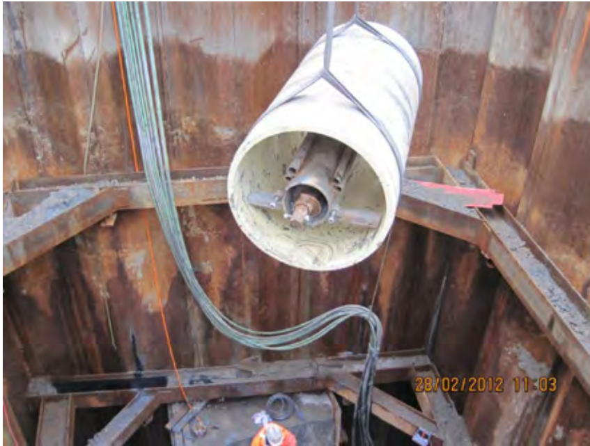
Figur 4 Sjakt S26 ved Tollbugata. Nytt rør fires, med innerrør og skrue. Rørdiameter 1030 mm.
