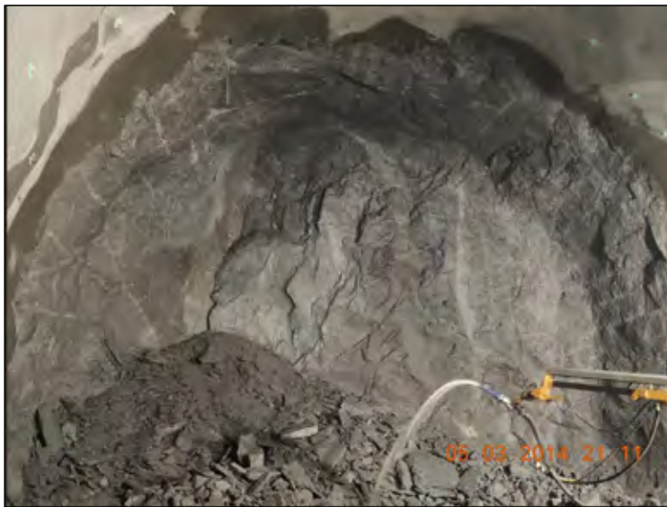
Figur 9: Flaking på stoff og avskaling i heng i Storberget tunnel, pel 178 080. Legg merke til form på fragmenter i renskemasser på sålen.
