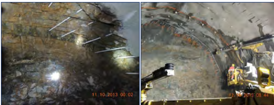
Figur 6. Spilingbolter og monteringen av buer på stoff Kjennåsen venstre. Legg merke til at spilingbolter har stanset videre brudd/rasutvikling
