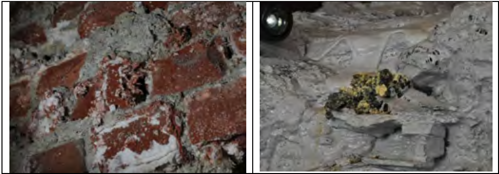
Figur 3: Figur til venstre viser magnesiumsulfat som krystalliserer inne i teglstein. Det er en gradient fra fukt i kontakt med alunskifer og inn i bygning med tørre veggflater. Fagområdet med denne kompetanse er uklart. Figur til høyre viser forsegling påført alunskifer der ikke all forvitret materiale er fjernet. I bildet vises dannelse av sulfater gjennom membran. Over mineralene vises strekk i membranen som skyldes fortsatt volumutvidelser i alunskiferen. Det er også her fuktgradient fra skifervolumet og ut mot tørrere luft.
