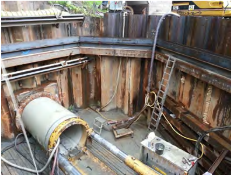
Figur 8 Spuntgrop A18a ved Akerselva. Herfra ble det presset i to retninger. Rørdiameter 1,4 m. Merk avstivningssystem til høyre for fordeling av krefter og overføring av krefter fra spuntveggen til bunnplaten.
