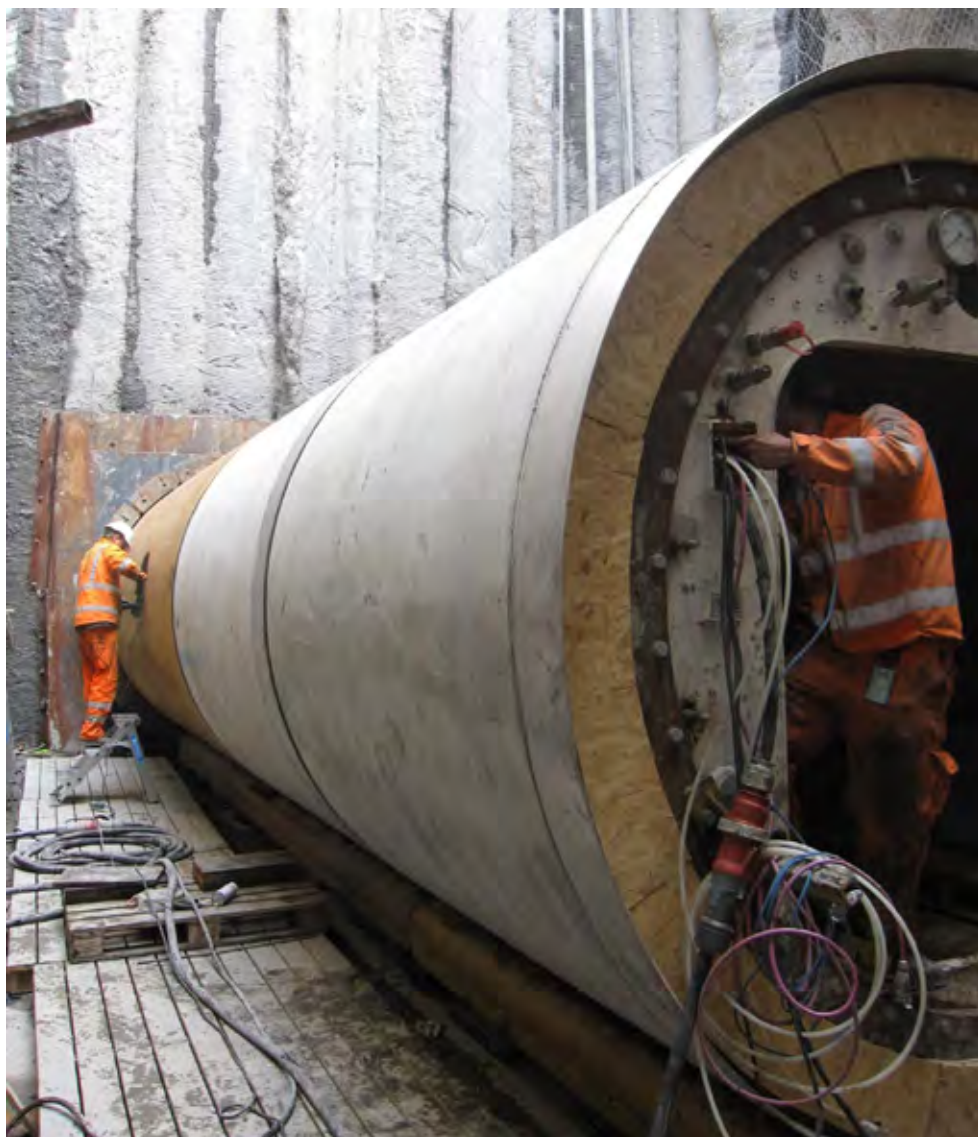
Figur 31 Fra sjakt S9. Rigging før pressing mot S7. I forgrunnen trykklusen med alle koblingene.
