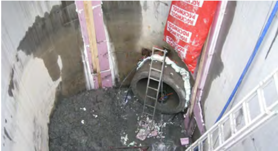
Figur 12 Sjakt S3, midt i en rundkjøring i vestre ende av Dronning Eufemias gate.
