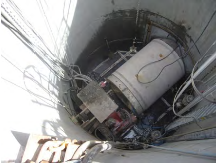
Figur 10 Sjakt S2 ved Strandgata. Sjakten er etablert som plasstøpt senkekasse. Relativt enkelt presseutstyr. Mikrotunneling mot S3. Rørdiameter 1,4 m.
