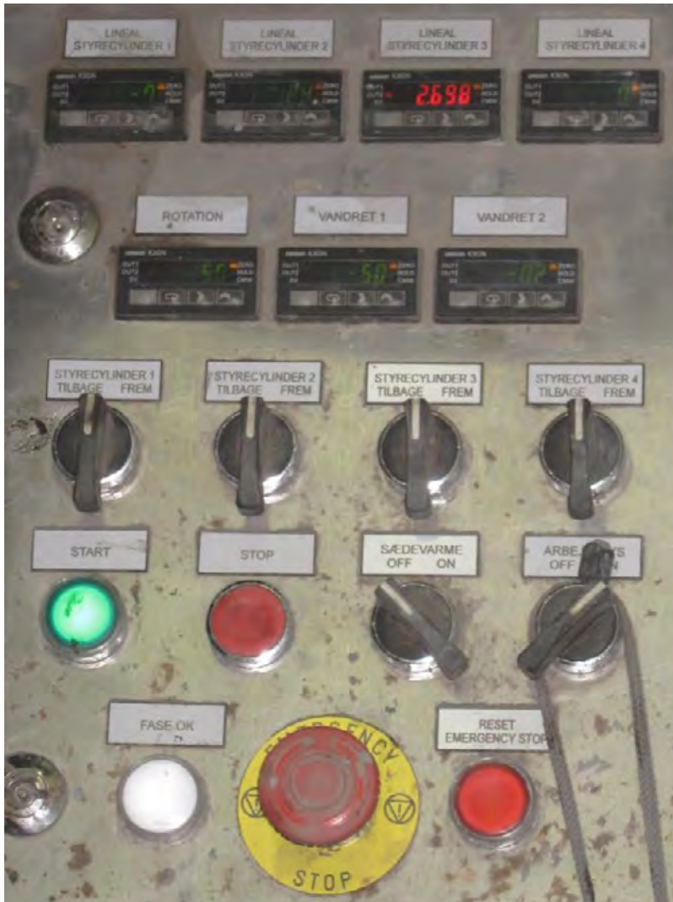
Figur 27 Detalj fra operatørens styringspanel. Merk at setevarmen ikke står på. Det var 20 °C inne i tunnelen, til tross for kuldegrader ute!
