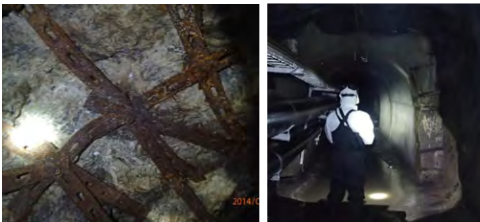
Foto 1 Korroderte bergbånd til venstre og sikringsstøp i god forfatning til høyre
