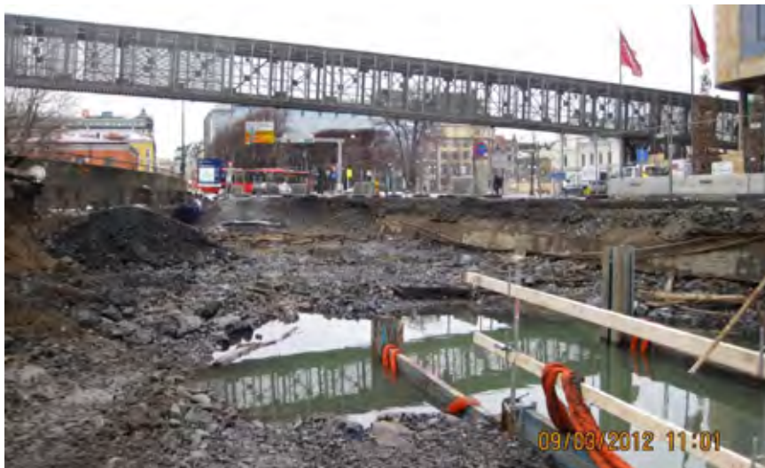
Figur 23 Rørlegging mellom sjakt S4 og S3, sett mot S3. Den midlertidige gangbroen til operaen krysser traseen.
