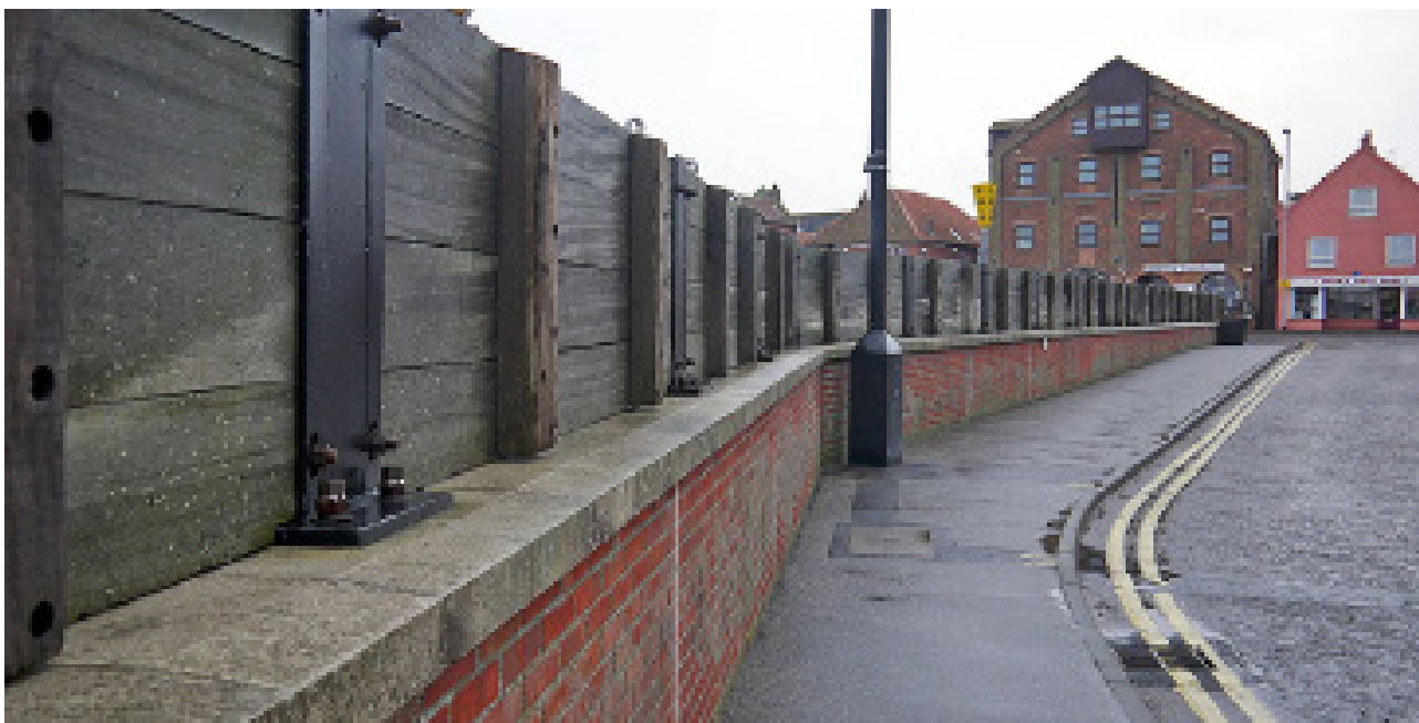
5. sz. kép: Fából készült mobil árvízvédelmi fal Forrás: Glass Floodwall Sea Defences ( www.floodcontrolinternational.com )
