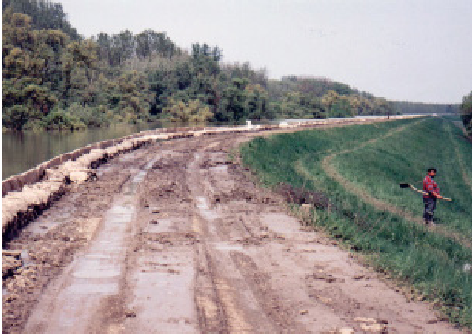
1. kép: Felázott, járhatatlanná vált korona a gát felső rétegének öregedése miatt kialakult szivárgás hatására
