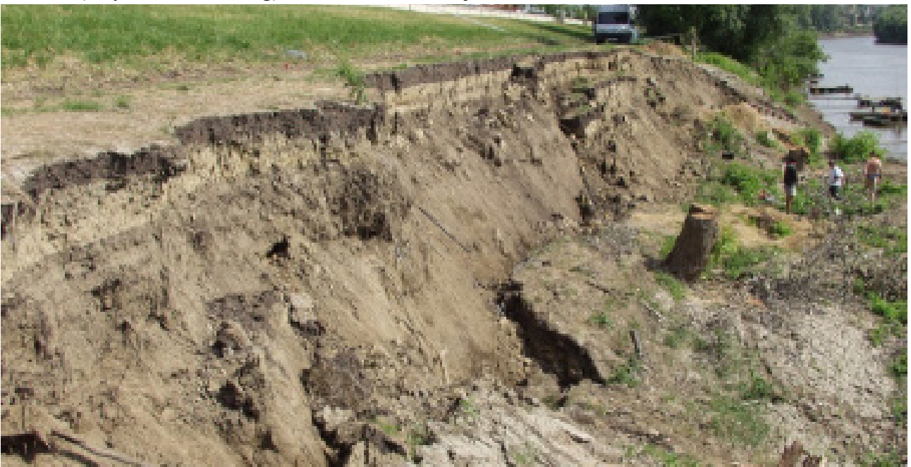
80. kép: Vízoldali suvadás Szolnok téglaházi szakasz, újvárosi gát
