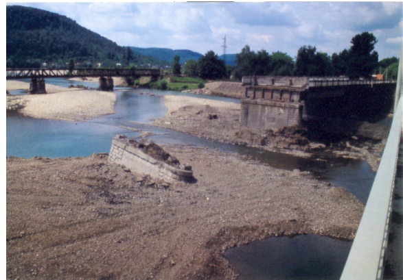
111. kép: A Nagy-ág torkolatánál 1998-ban az áramló víz elmosta a hídpillér környezetében a talajt, a pillér megsüllyedt, ami híd lebontásához vezetett.
