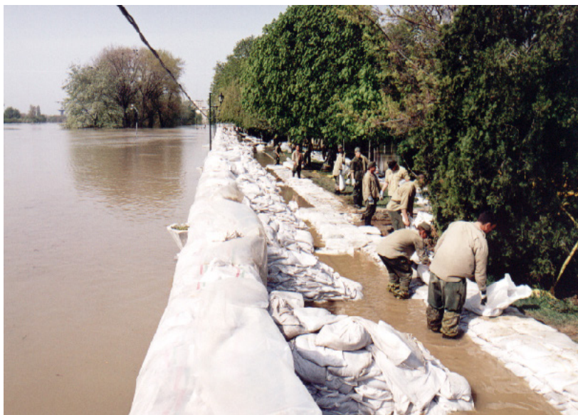
14. kép: Szolnok parti sétány parapetfal magasítása 2000-ben. A képhez tartozó keresztmetszet a 10. ábrán látható.
