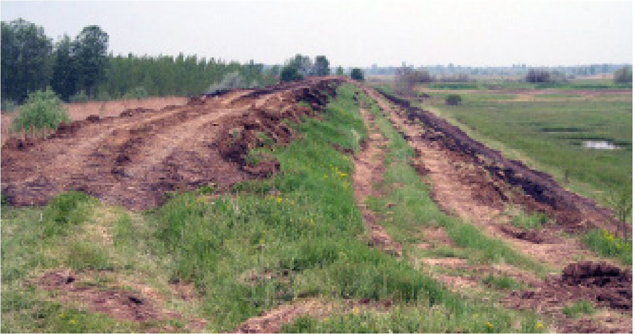
4. kép: Töltésfejelés egy lokalizációs gáton a 2006 évi árvízvédekezéskor. Valószínűleg a humusztalanítás elmaradt. A helyszínre szállított föld túl nagy rögöket tartalmazott.
