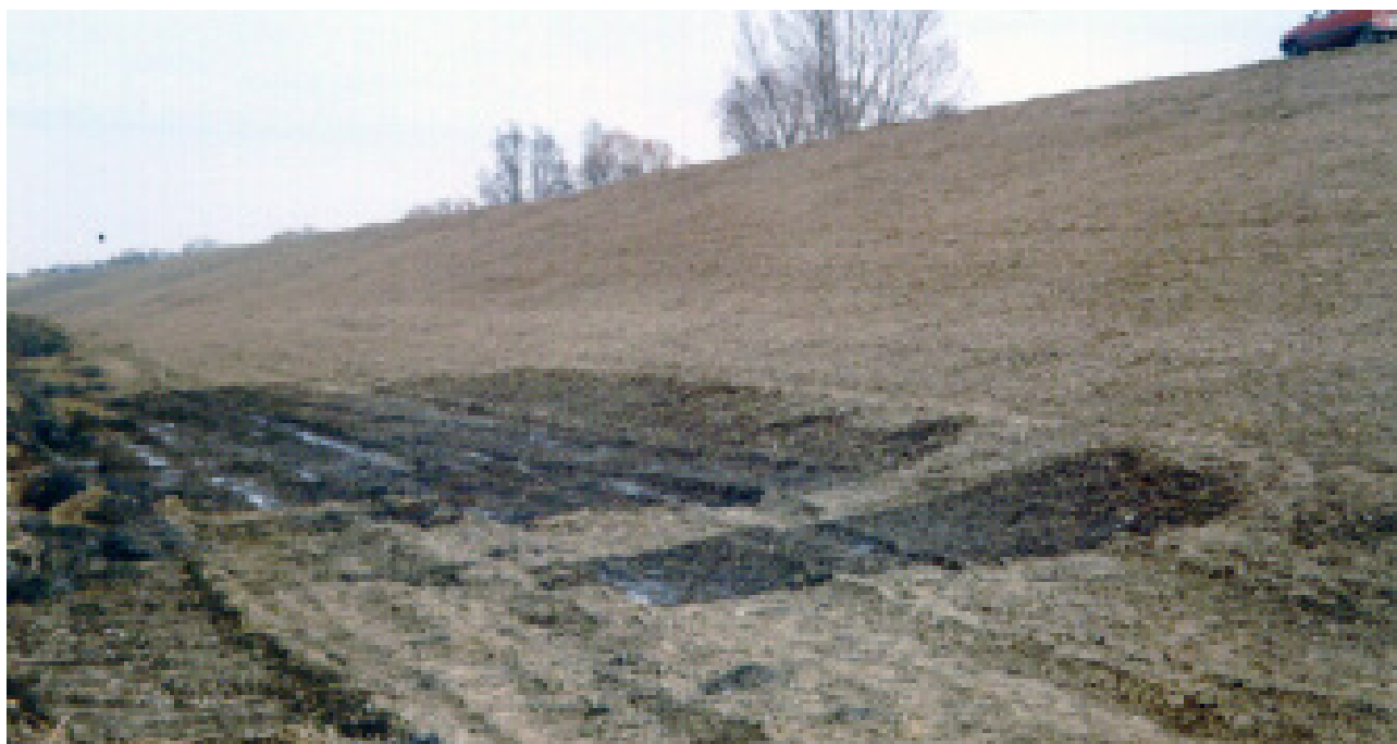
44. kép: A szivárgó víz megjelenése a Kettős-Körös jobb parti töltésén
