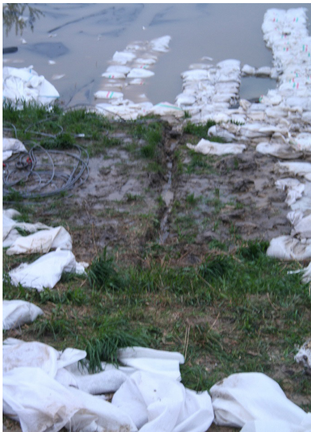
47. kép: Szivárgó vizek kivezetése a gátból
