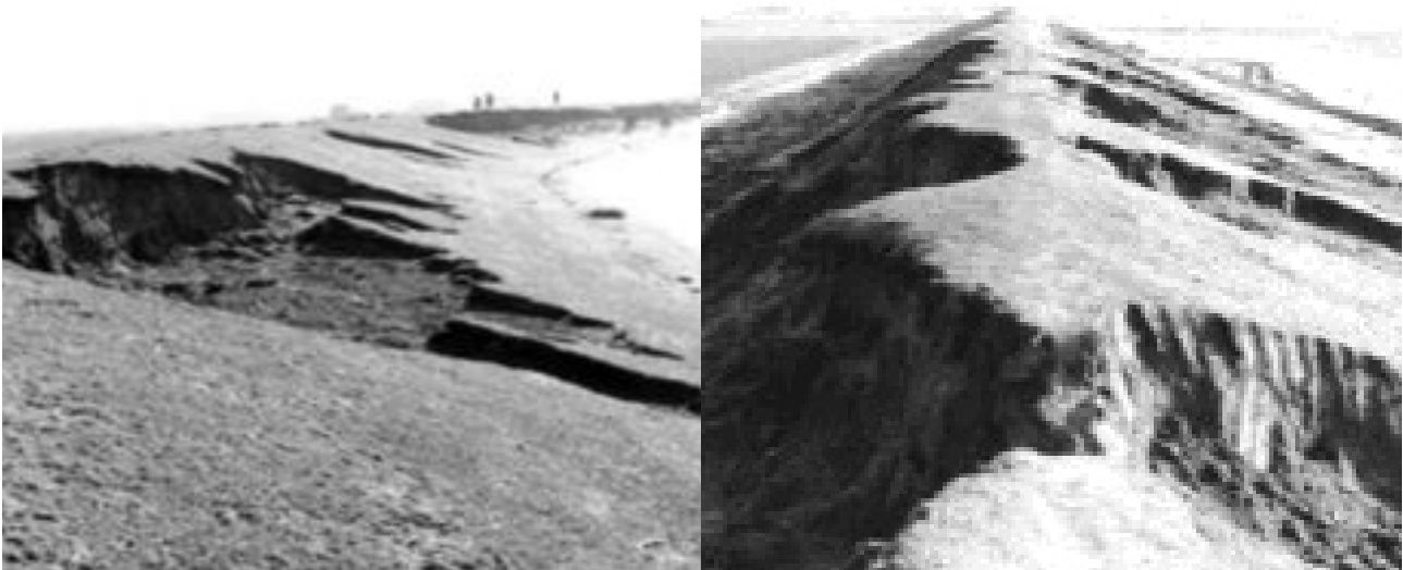
22. kép: Töltésrésű elhabolása a vízoldalon (bal oldali kép) és mindkét oldalon (jobb oldali kép) az átcsapó hullámok hatására.
