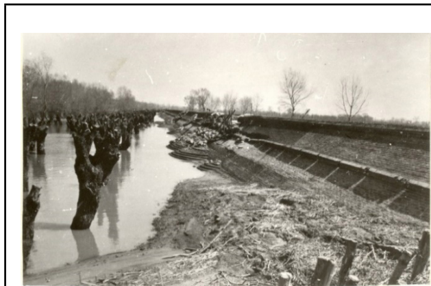
24. kép: 1940. áprilisi orkán hatása a téglá rézsűburkolatra Tiszaderzsnél. A csonkolt fűzek hullámvédelme elhanyagolható volt.
