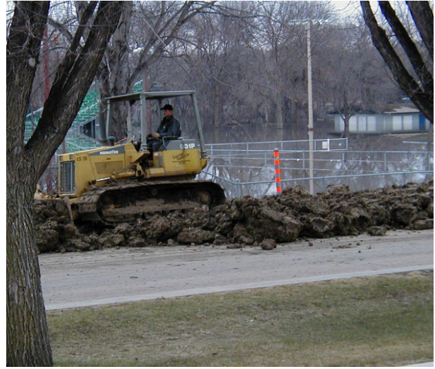
7. kép: Földből készülő nyúlgát építésénél a rossz anyagnyerőhely miatt túlságosan darabos a beépítendő agyag. A földtoló nem tud megfelelően tömöríteni, tömörítő eszköz szükséges.
