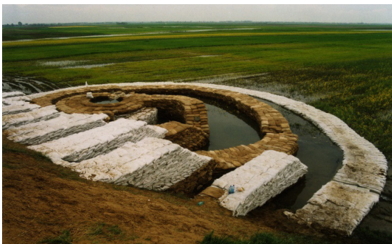
96. kép: Tiszasasi buzgár a 2000. évi árvízvédekezéskor. Felhasználva ~ 50 000 darab homokzsák a vízoldali védekezéssel együtt
