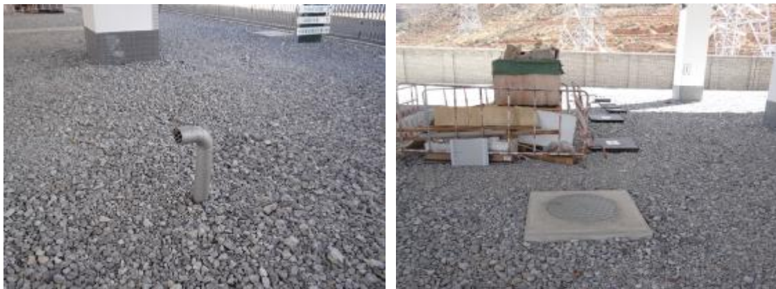
照片 3.1-2 一期工程生活污水处理设施及事故油池照片
