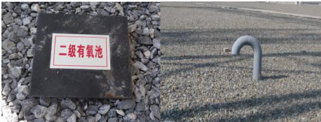
照片 3.1-3 一期工程生活污水处理设施及事故油池照片
