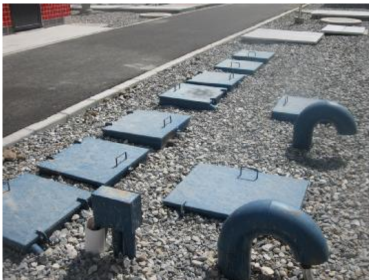
照片 3.1-1 一期工程生活污水处理设施及事故油池
