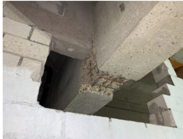
Bild: Betonabtrag am Querträger nach Demontage von PCB-haltigen Fugenmassen
