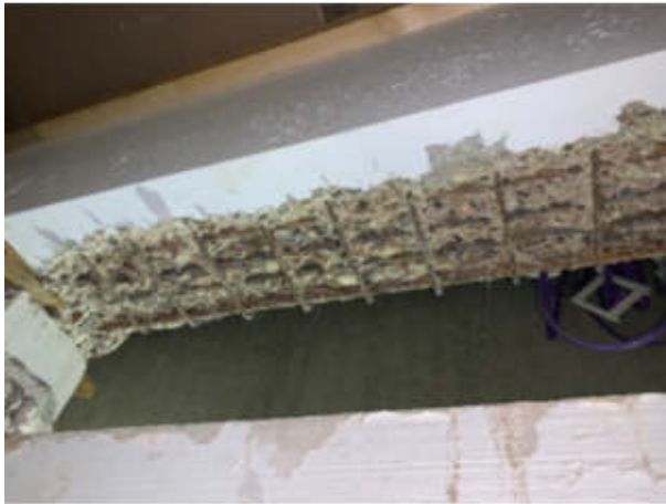
Bild: Betonabtrag an einem Unterzug nach Demontage von PCB-haltigen Fugenmassen
