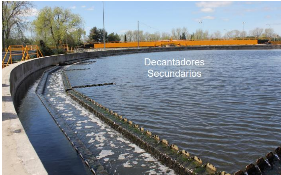
Figura 13: Decantadores secundarios en funcionamiento.
