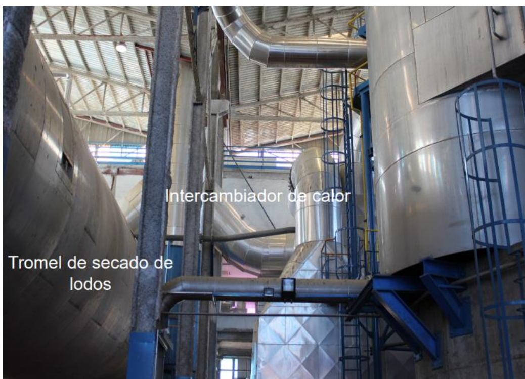
Figura 29: Secador mixto. tromel de secado de lodos y caldera de intercambiador de calor.
