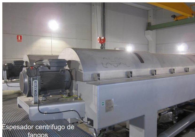
Figura 19: Espesador centrífugo de fangos.
