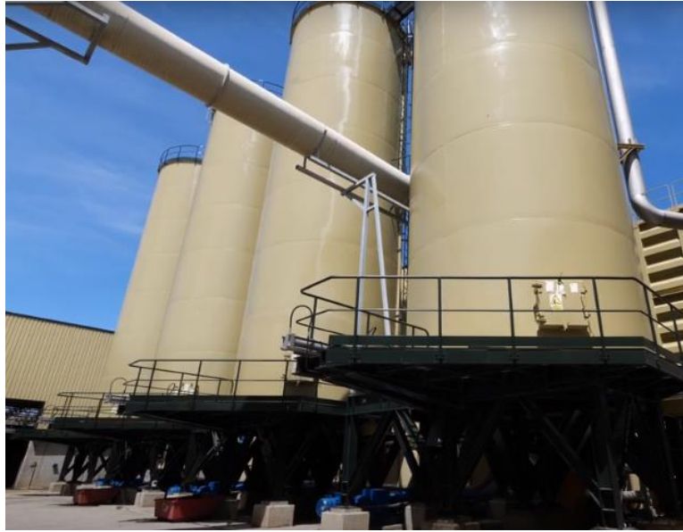
Figura 28: Cinta transportadora y tolvas de almacenaje. EDAR sur.
