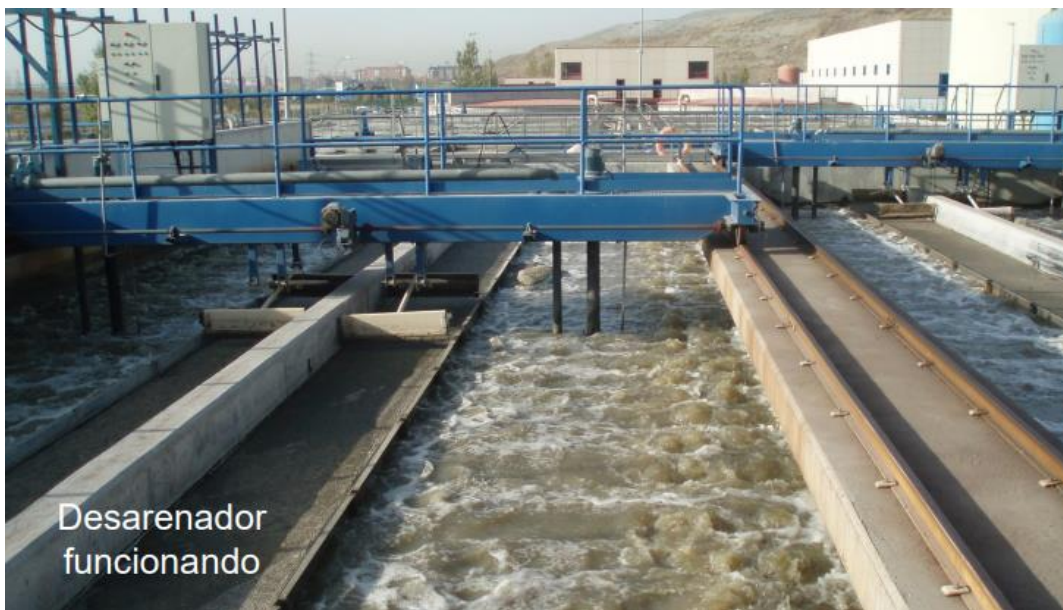
Figura 11: Pretratamiento de aguas residuales. Canal y carro desarenador en funcionamiento.
