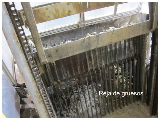
Figura 10: Fase de pretratamiento de aguas residuales. Desbaste y tamizado
