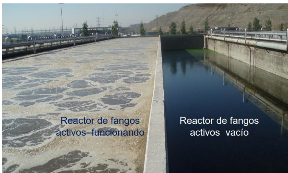
Figura 14: Reactor de fangos activos funcionando y sin funcionar.
