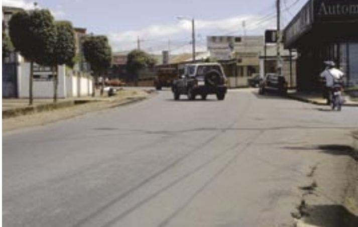
Deformación de la mezcla en una avenida capitalina.
