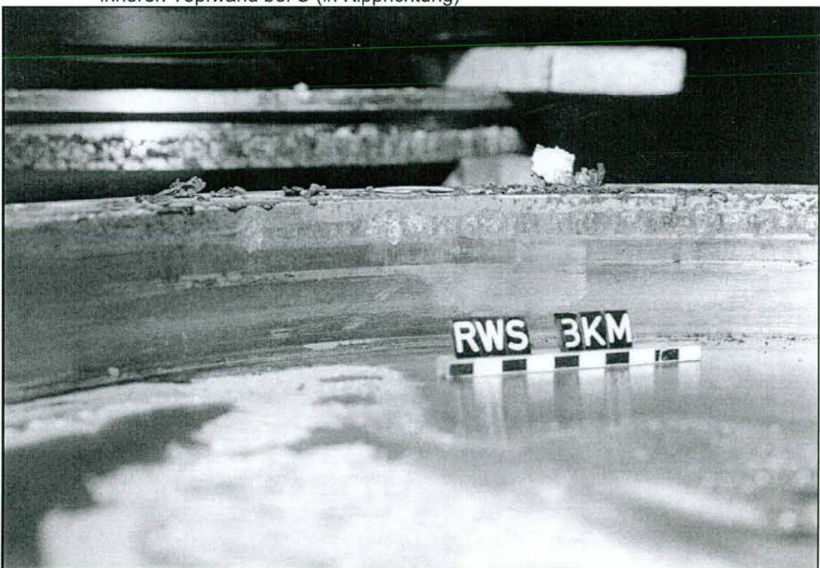
Abb. 9.16: Lagertopf nach Ausbau des Elastomerkissens: Kontaktflächen des Deckelbunds und der UHMWPE-Innendichtung an der inneren Topfwand bei C (in Kipprichtung)
