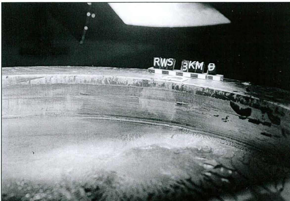
Abb. 9.17: Lagertopf nach Ausbau des Elastomerkissens: Kontaktfläche der UHMWPE-Innendichtung bei D (in Kipprichtung)
