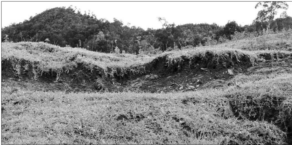
Figure 12 : érosion en cours sur les bords nord de l'allée centrale : mise à nu du substrat rocheux
