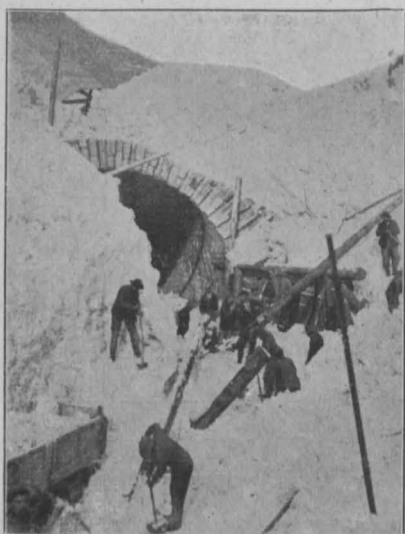
Abb. 16 Abräumen der Schneemassen der Rück-Lawine am 23. Jänner beim Südportal des Lötschbergtunnels
