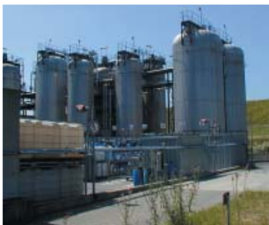
Tanklager der Sonderabfallverbrennungsanlage Schöneiche, V. Döring (SBB mbH)
