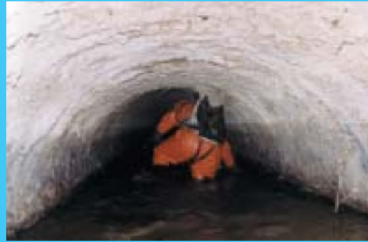
Hauptsammler ▶ Gubener Straße - Zu- standserfassung: starke Inkrustation
