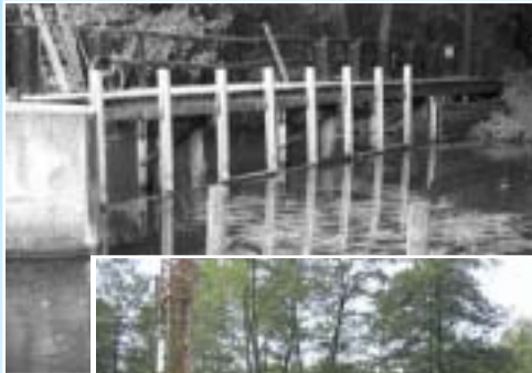
Staufufe Wehr 131, vorhandener Zustand der alten Anlage
