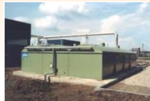
Abb. 2: Geschlossener Biofilter (Quelle: Tholander Ablufttechnik GmbH)
