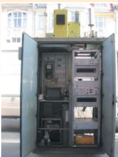
Messcontainer in Cottbus, Bahnhofstraße
