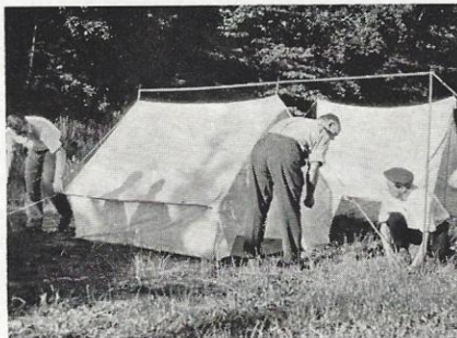
Her er telekommunikationsfolkene ved at stramme bardunerne. Fra venstre: Montør J. Kanding, chauffør Sv. Førsterling og montør Bent Jensen.
