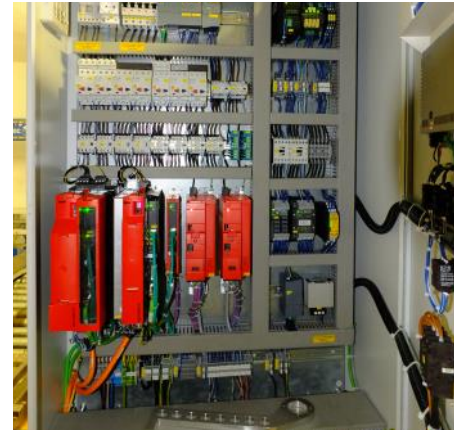
Schaltschrank Electrical cabinet
