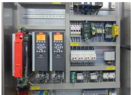
Schaltschrank Electrical cabinet
