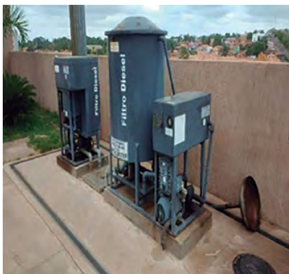
Figura 14 - Filtro de óleo diesel.
