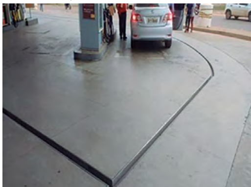
Figura 8 - canaletas de contenção na área de abastecimento.
