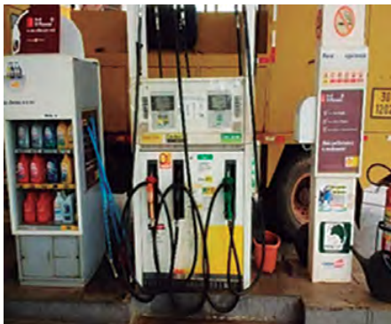
Figura 13 - Bombas sêxtulas eletrônicas.
