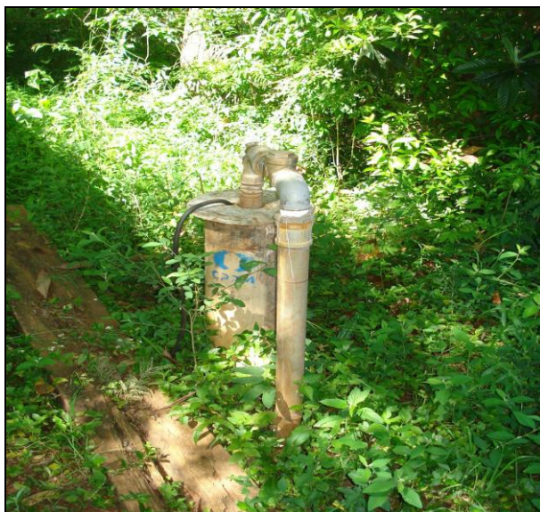
FOTO 01 – Captação da Água
