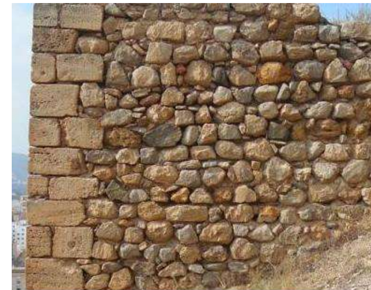
Imagen: Mampostería con encadenado de sillería (M3/S3) de la torre de factura aragonesa C041. Fuente: Elab. Propia.
