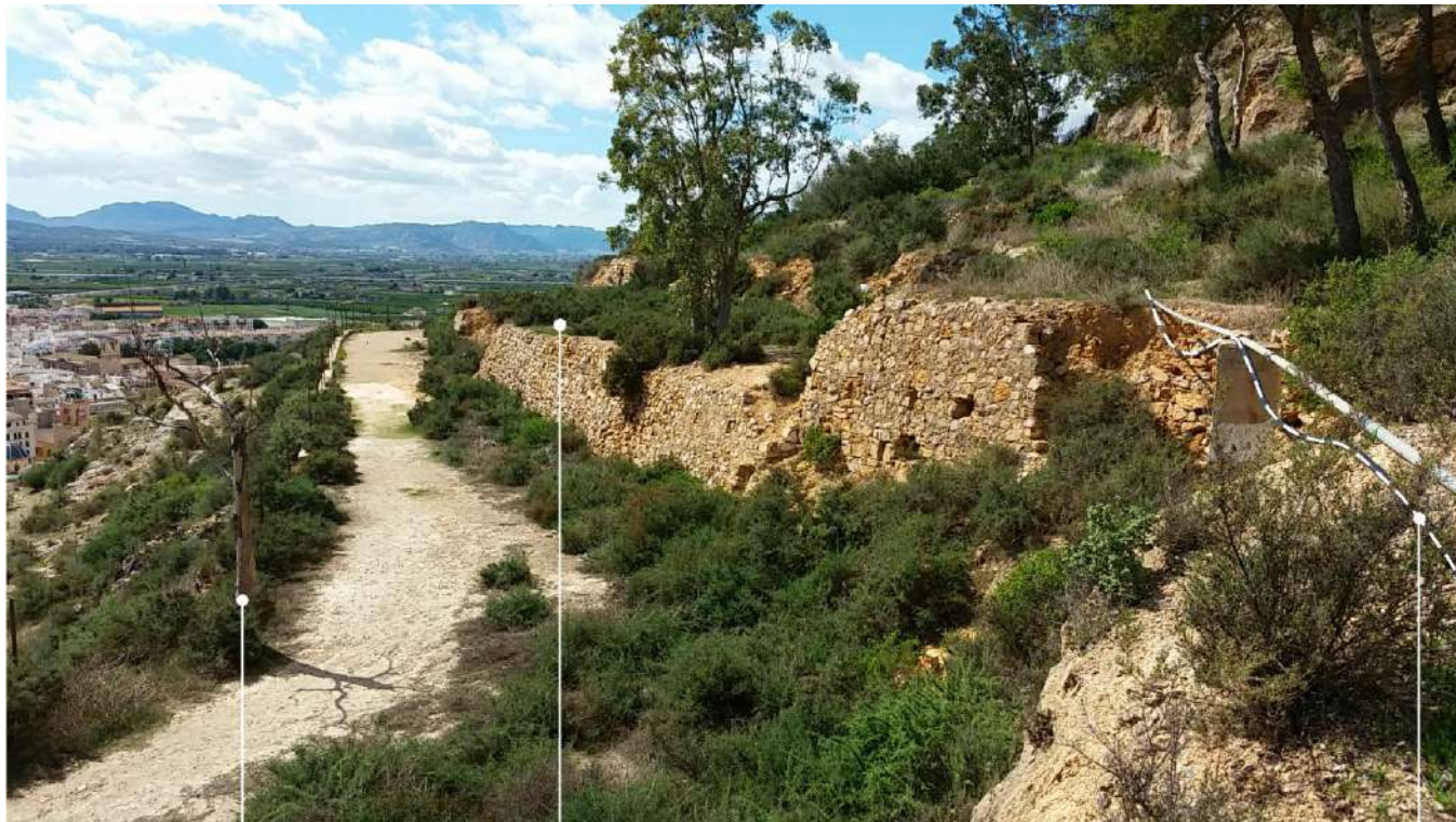
Falta de mantenimiento en vegetación
