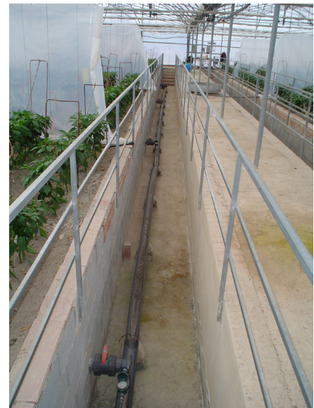
Foto 32. Recogida de lixiviados por canaleta en el fondo del lixímetro. Campañas 1999-2000, 2000-2001, 2001-2002 y 2002-2003.
