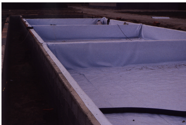
Foto 11. Detalle del film de impermeabilización de los lixímetros y tubería corrugada de salida de drenajes.
