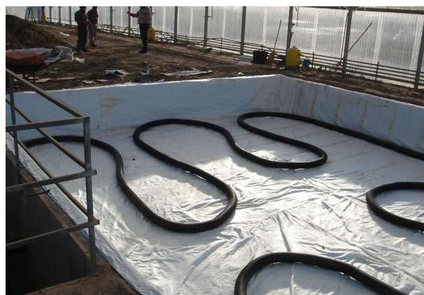
Foto 12. Detalle de la impermeabilización de los lixímetros y tuberías de drenaje hacia el foso de recogida de lixiviados.
