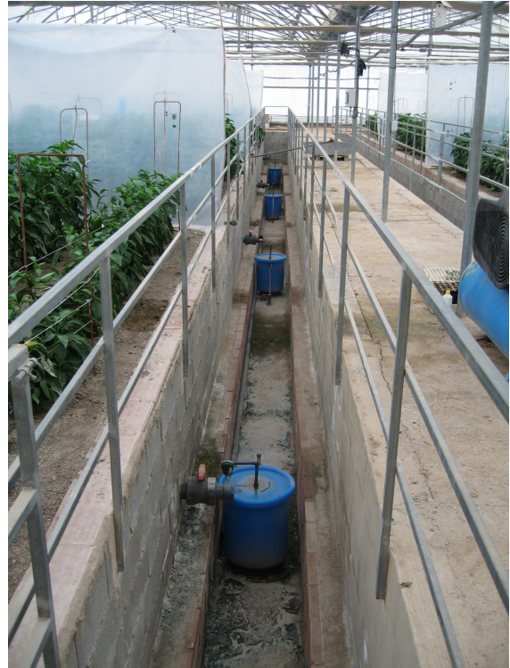
Foto 15. Aspecto del foso de recogida de lixiviados, marzo 2006. Se aprecia la separación de las distintas parcelas experimentales por mamparas.
