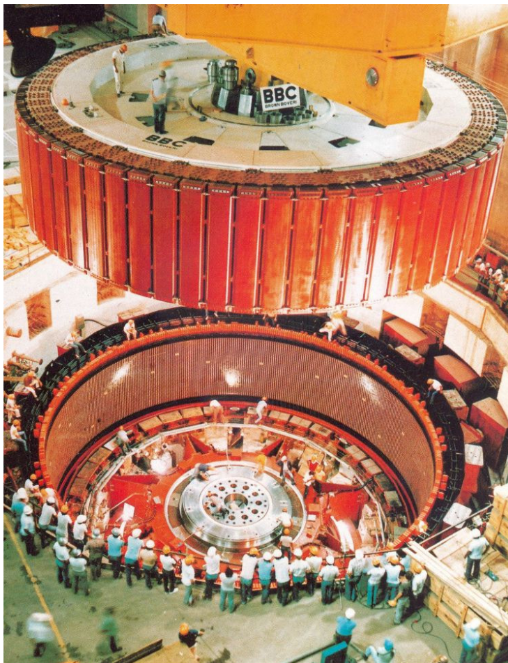
Fig. 18: Hidroalternador síncrono trifásico de la central de Itaipú de 824 MVA, 90 r.p.m., 60 Hz (Fuente: Revista ABB, n° 1, 1992).
