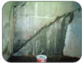
Etapa 1 Filtración de Agua
