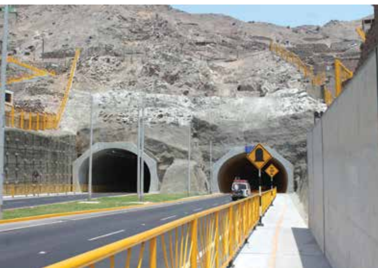
Ingreso y salida de los túneles desde la zona de San Juan de Lurigancho. Hacia el lado izquierdo se puede observar el muro de soil nailing empleado como muro de contención.
