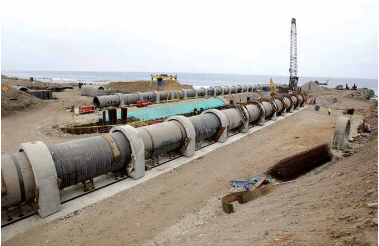
Planta de tratamiento La Chira
