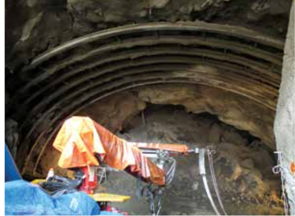
Trabajos de encofrado en la zona de derrumbe e instalación de cimbras y lanzamiento de shotcrete.
