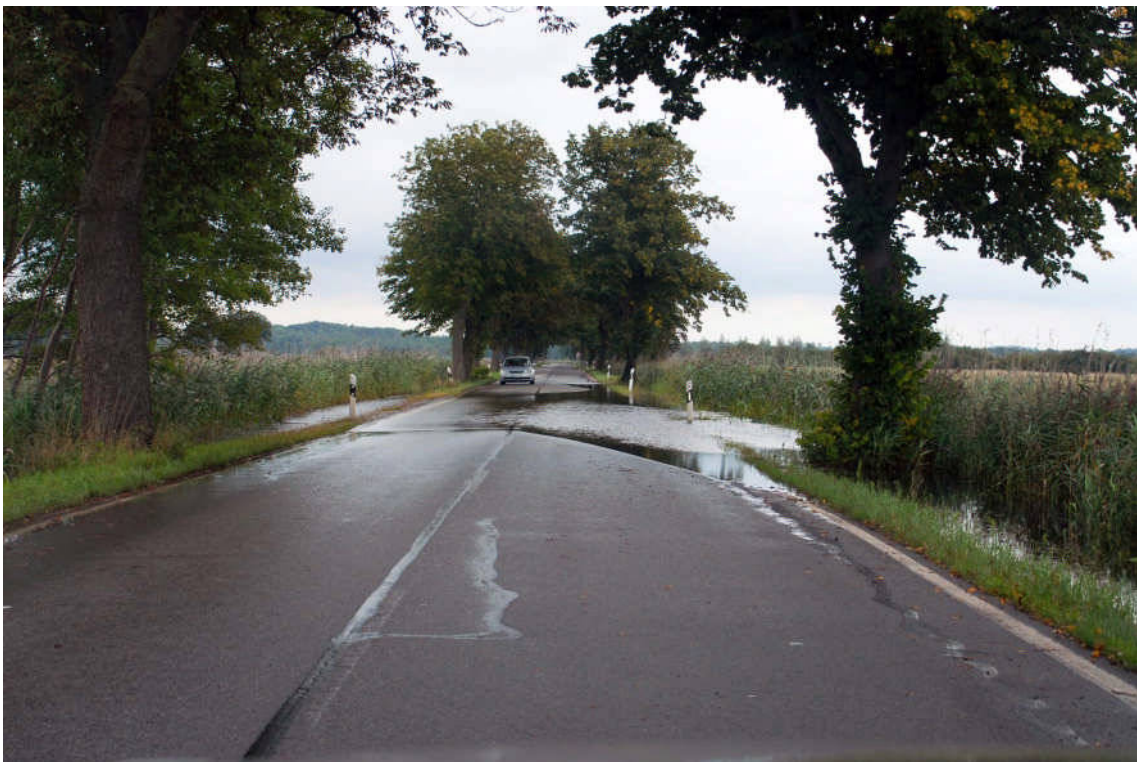
Abbildung 1 Überflutete Straße zwischen Bad Sülze und Kavelisdorf (L23) nach Starkniederschlägen Ende Juli-Anfang August 2011
