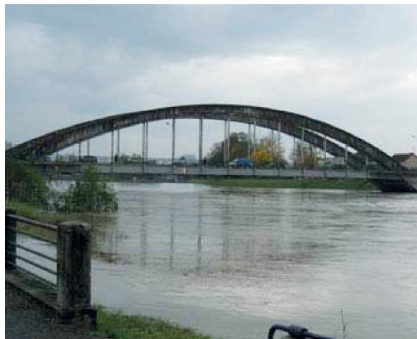
Figure 8 : Ouvrage sur une « rivière de plaine » au débouché hydraulique largement dimensionné (Source : LR de Blois)
