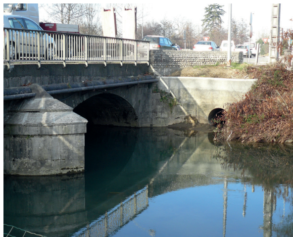
Figure 10 : Ouvrage en maçonnerie sur « rivière de plaine » au débouché hydraulique mal dimensionné (Source : DIR Atlantique)
