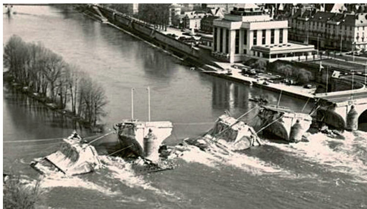
Figure 1 : Exemple d'affouillement généralisé : l'effondrement du pont Wilson à Tours (1978) (Source : R. Lozelli, P. Fitou, G. Proust - la Nouvelle République)
