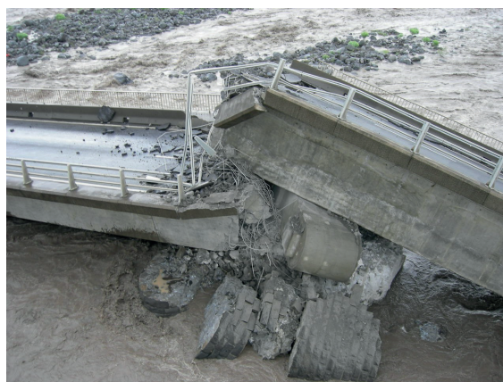
Figure 2 : Exemple d'affouillement « local » : l'effondrement du pont sur la rivière Saint-Étienne à la Réunion (2007) (Source : Cerema)
