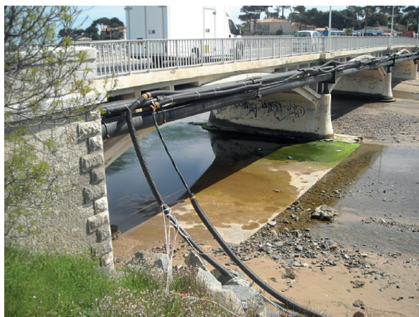
Figure 37 : Radier béton mis à nu au droit de la travée 1 du pont de la Galiote à Fréjus (83) (Source : Cerema Méditerranée)
