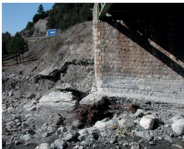
Figure 13 : Affouillement d'une culée en saillie d'un pont (Source : Cerema Méditerranée)
