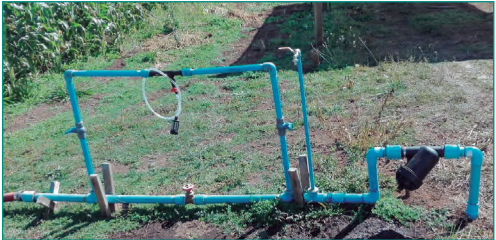
Figura 18. Sistema de fertirrigación que se muestra el Inyector Venturi, instalado a metros del inicio de la siembra
