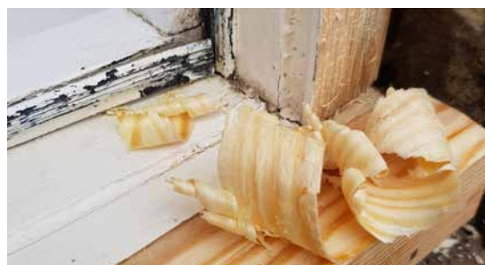
Fönsterkarmar som renoveras med rötbeständig fetved från tall. Fetvedens vänner. Foto: Mikael Tiljestränd Edström.
