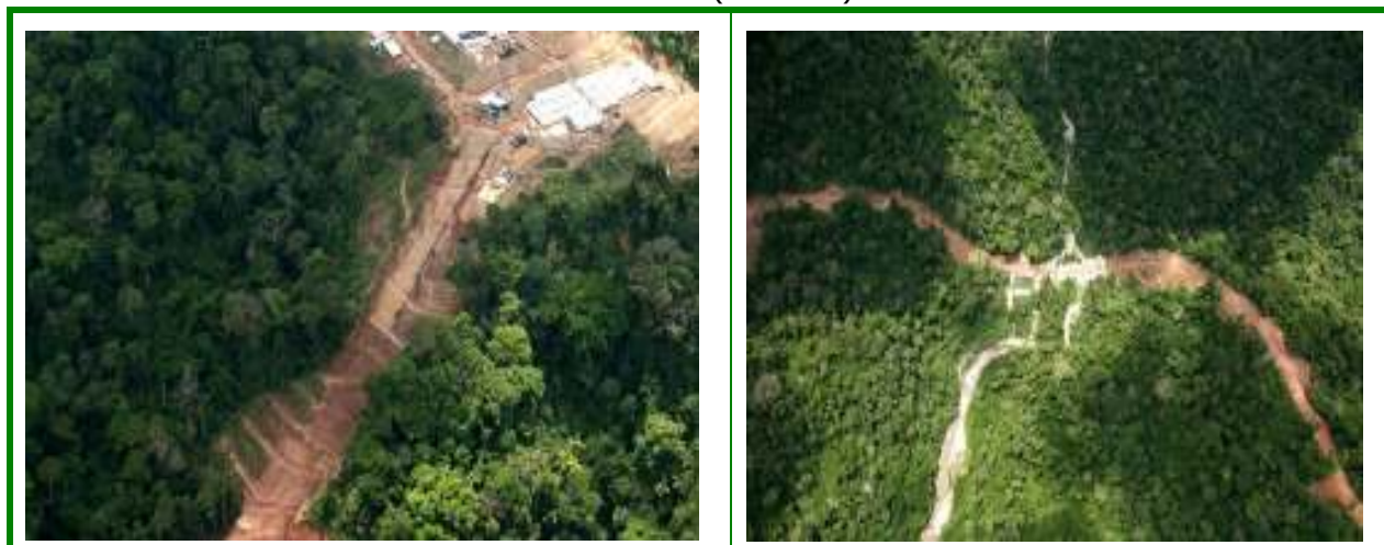
Figura 24. Obra de acceso del DdV a Cashiriari 3 en con fuerte pendiente topográfica (izquierda). Cruce de quebrada en el Kp43,9; que se encuentra previo a la plataforma Cashiriari 3 (derecha).
