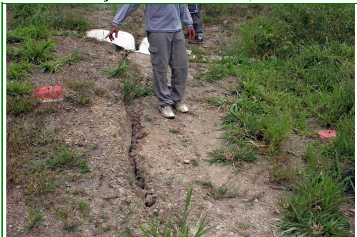
Figura 30. Grieta sobre el DdV en el Kp95.
